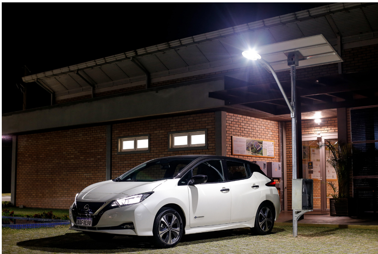
Figura 4 – Projeto Nissan e UFSC para testar baterias de segunda vida do LEAF para armazenar energia de postes de luz solar
