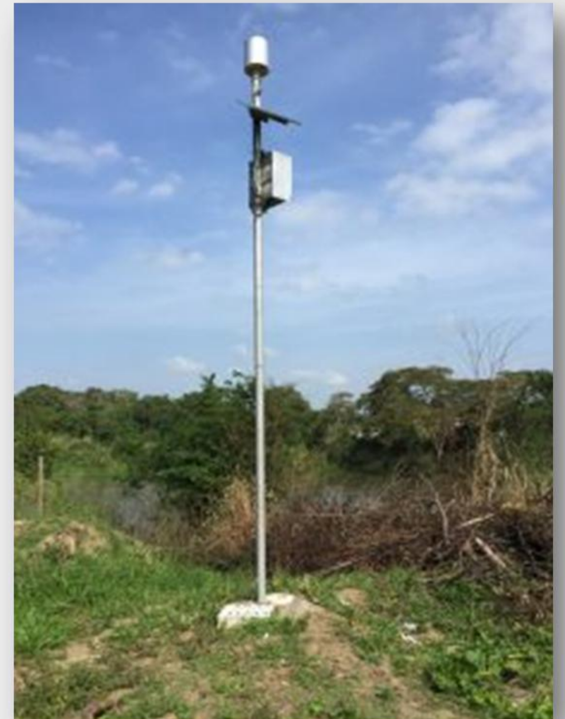
Estação Telemétrica INEA
