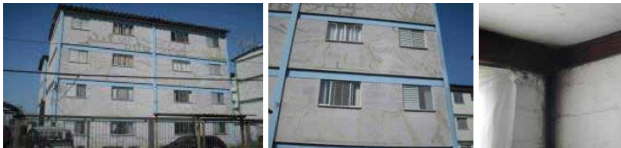
Figura 35 | Fissuras generalizadas na vedação e infiltração no encontro alvenaria estrutura
