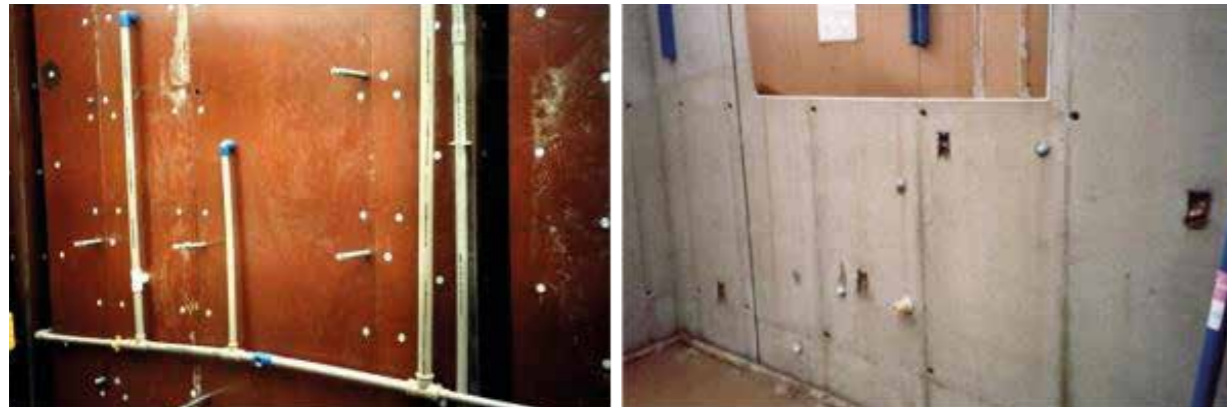
Figura 31 | Sistema de paredes maciças com embutimento de sistemas hidráulicos, sem a possibilidade de manutenção futura
