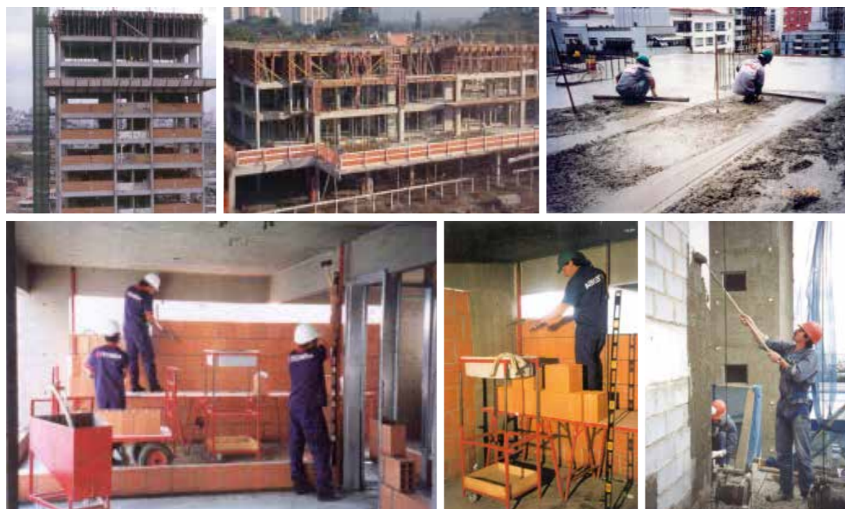
Figura 22 | Exemplos de métodos e processos construtivos racionalizados II. Métodos construtivos racionalizados de produção de estrutura de concreto armado moldada no local, vedos de alvenaria de blocos de concreto e cerâmico e revestimentos de argamassa desenvolvidos e aplicados na construção nacional, a partir do início dos anos 1990
